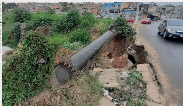
Cratera em via pública de Guarulhos apresenta risco de acidente
